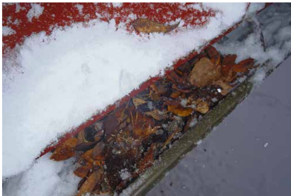
Talvi on yllättänyt rännien puhdistajan (kuva Tapio Rokkonen)
